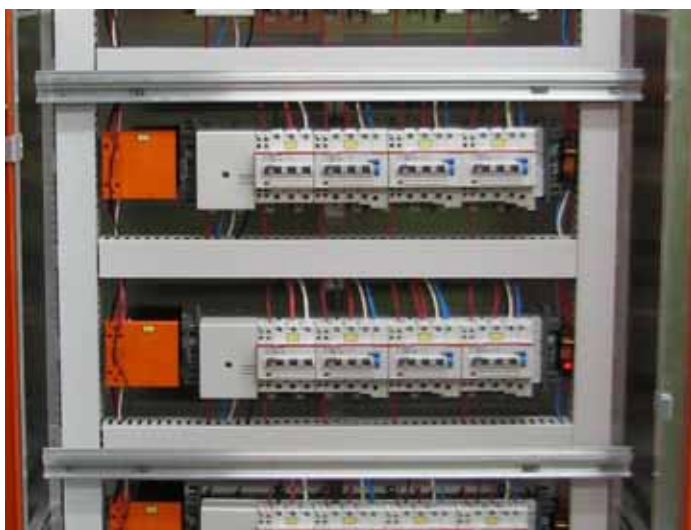
Bild 2 Steuerung der Adaptionsbeleuchtung
