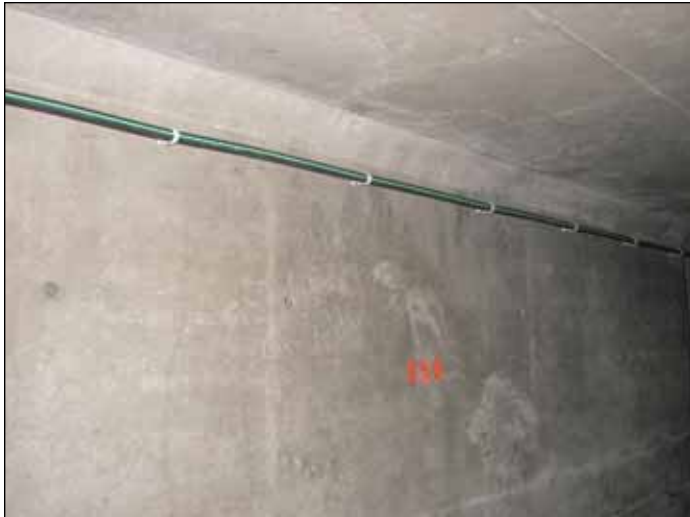
Bild 1 Lage Strahlungskabel unter Fahrbahn
